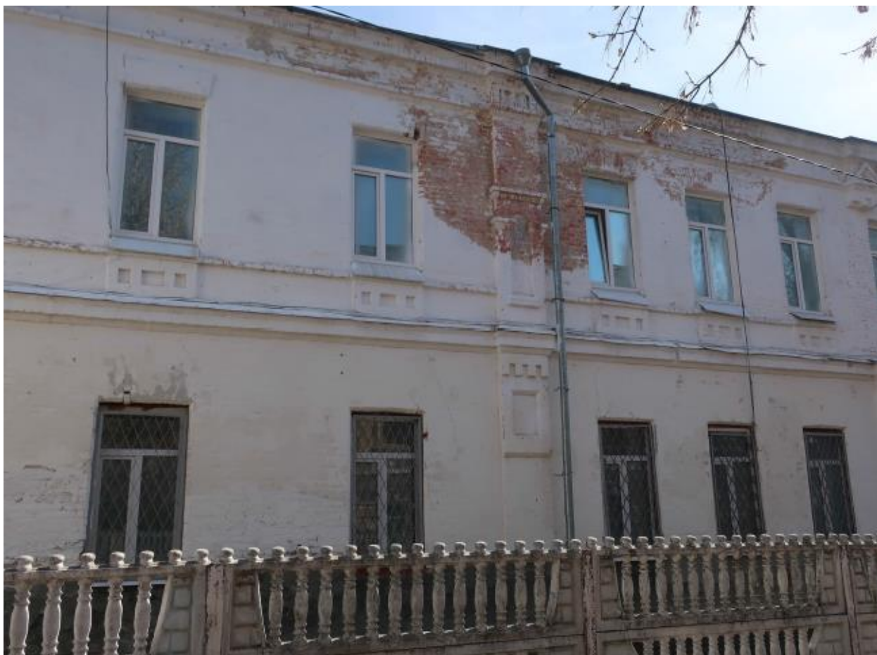
Точка фотофиксации 5. Западный (боковой) фасад со стороны восточного фасада дома №15 по ул. Тухачевского
